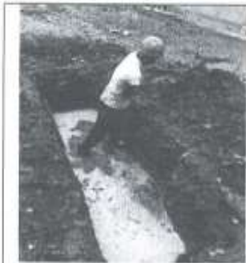
Imagen n.º 1 se observa una zanja aperturada con la existencia de nivel freático a -0.60 del nivel terreno natural.
